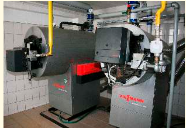
Kotłownia w Centrum Administracyjnym po termomodernizacji
