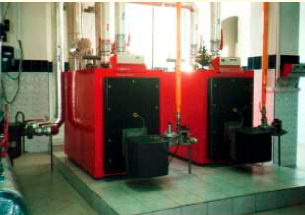
Kotłownia w Zespole Szkół Nr 1 w Limanowej po termomodernizacji
