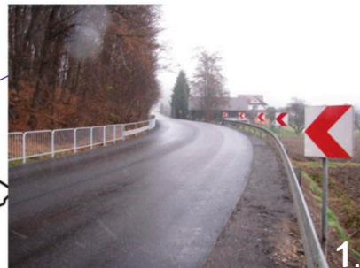
„Przebudowa drogi powiatowej nr 1555K Łososina Dolna – Ujanowice – Młyne w m. Kobylczyna, Ujanowice, Strzeszyce, Krosna, Kamionka Mała, Laskowa, Powiat Limanowski” (inwestycja w trakcie realizacji przewidywany termin zakończenia 2024 rok)
